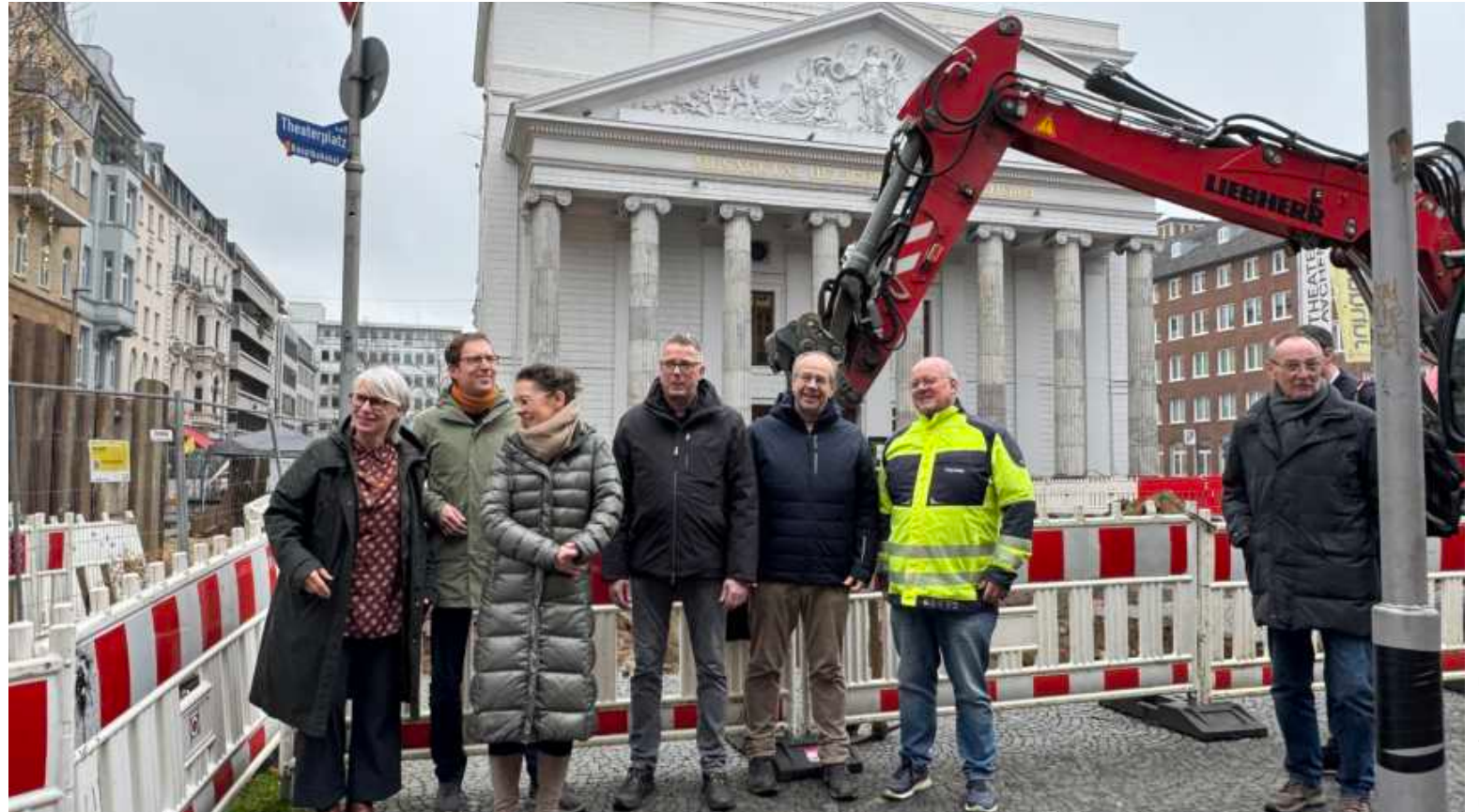
Das Theaterplatz-Team (v.l.): Stadtbaurätin Frauke Burgdorf, Projektleiter Philip Spahr, Silke Roder von der Städtischen Tiefbau-Abteilung, Robert Schmidt vom Gebäudemanagement, Stadtarchäologe Andreas Schaub und Ralf Jansen von Regionetz.
